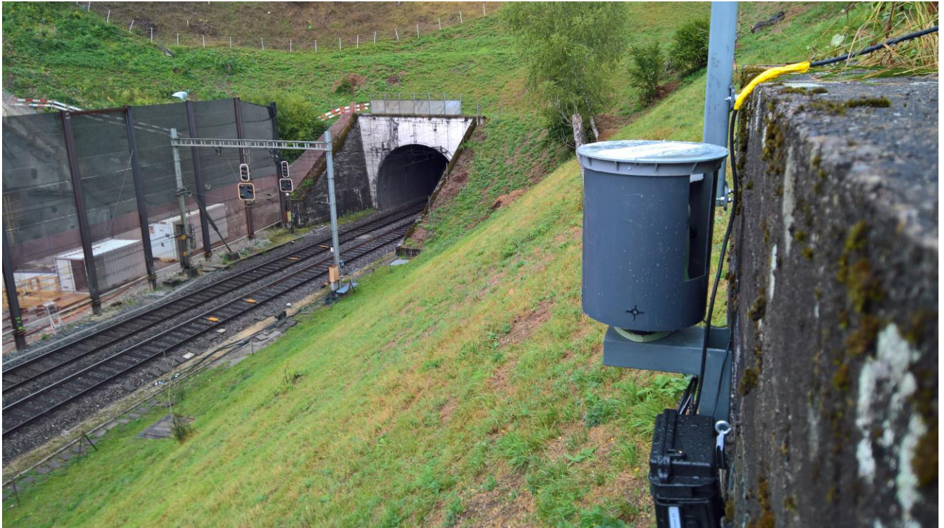
Überwachung Portal Schinznach, Bözbergtunnel AG.
